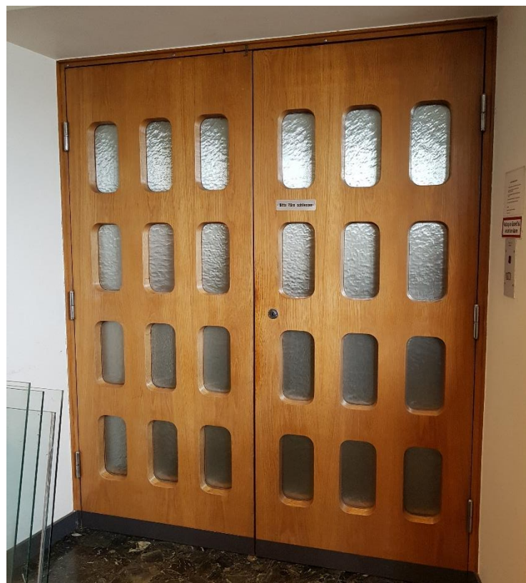
Abbildung 9: Doppelflügel Vollholztüre Aufzug, erstes Obergeschoss © BauKarussell
